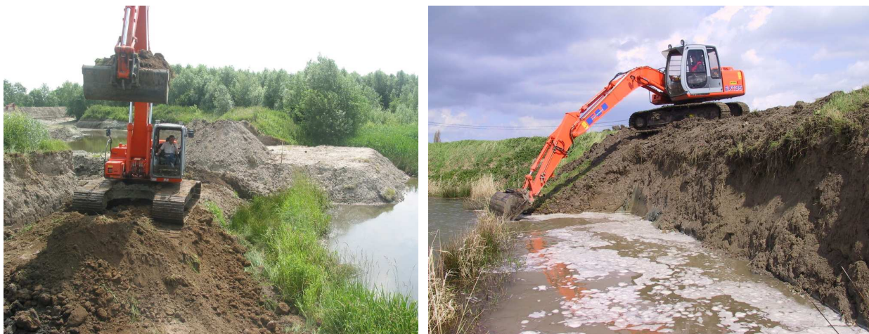
Foto 2: Aanleg van twee verschillende wanden met behulp van een hydraulische rupskraan © Kris Decler.
