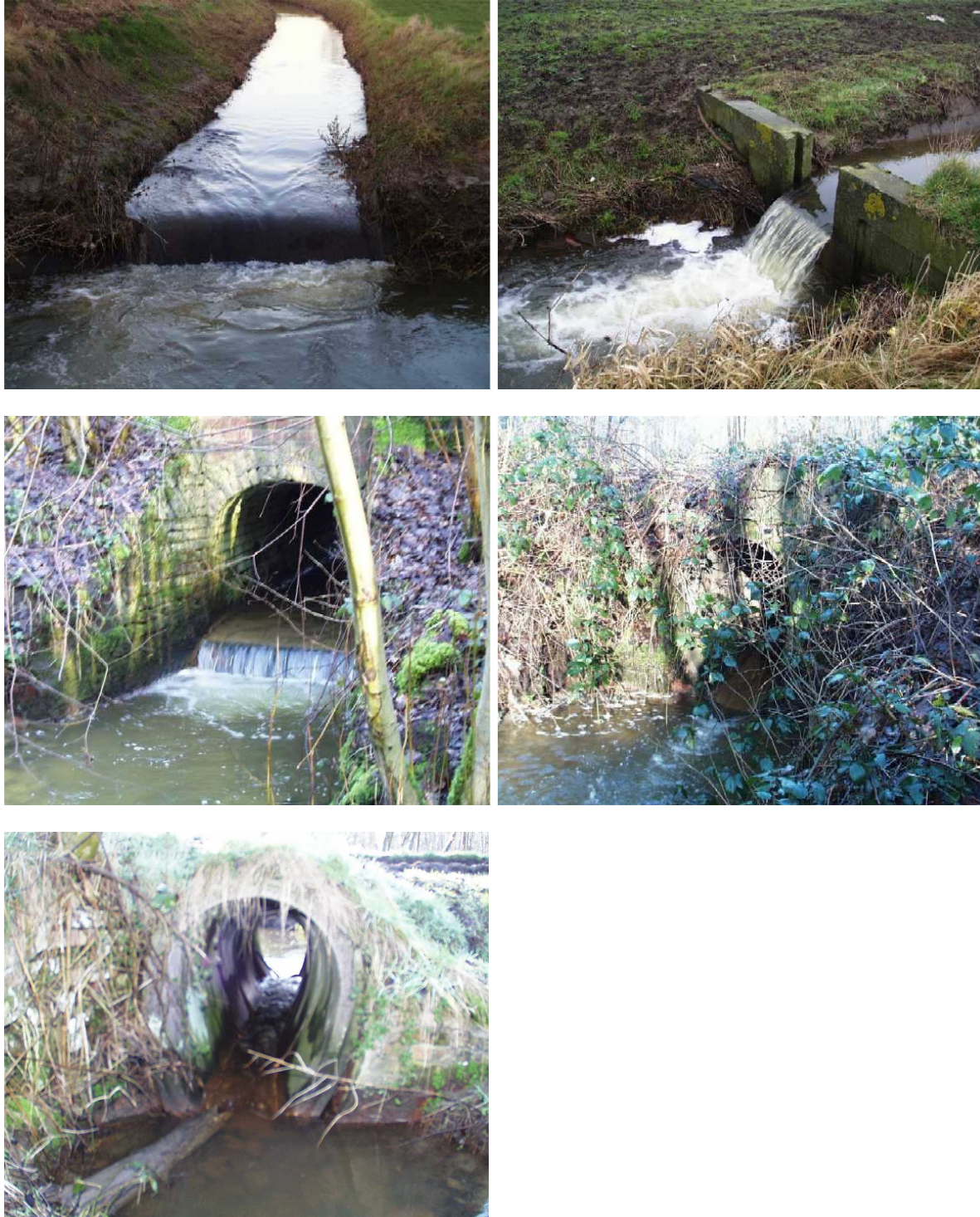
Figuur 2. Respectievelijke kunstwerken v.l.nr.r. en v.b.nr.o. 1841-010; 1841-110; 1841-140; 1841-150 en 1841-160 in de Kasteelbeek waarvan onduidelijk is of ze nog een (periodiek) vismigratieknelpunt vormen ( www.vismigratie.be ).
