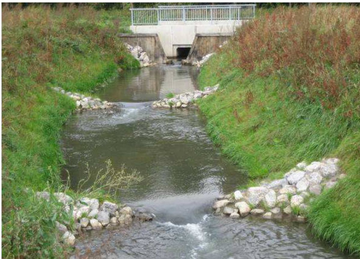
Foto 2: V-vormige bekkenvistrap met ruwe stortsteendrempels als bypass rond de Dalemse molen (Foto: Werner Mennen).
