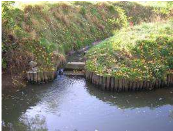
Foto 6: Verstopping van de inlaatconstructie in de visnevengeul in Nederzwalm had een verminderde attractiviteit en passeerbaarheid van de visnevengeul en uitlaatconstructie (met strekdam) tot gevolg.
