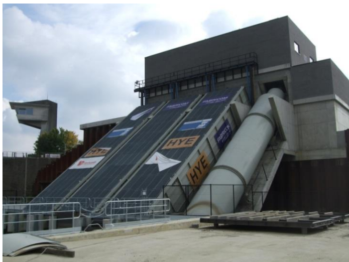
Figuur 2: Gesloten vijzelpompinstallatie te Ham
