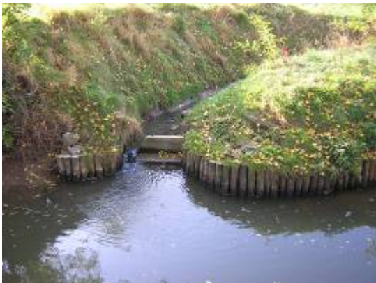
Figuur 4.5: Verstopping van de inlaatconstructie heeft een verminderde attractiviteit en passeerbaarheid van de uitlaatconstructie (= strekdam) tot gevolg (oktober 2007 – stroomafwaarts aanzicht).
