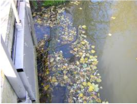
Figuur 4.3: Verstopping van de inlaatconstructie van de visnevengeul met boomstammen, takken en bladeren (oktober 2007 – stroomopwaarts aanzicht).
