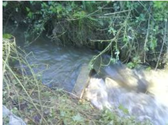
Figuur 4.20: Bij een volledig geopende schuif zijn de stroomsnelheden t.h.v. de strekdam hoog (tot 2\text{ms}^{-1} ) en ontstaat er een turbulente zone stroomafwaarts van de strekdam.
