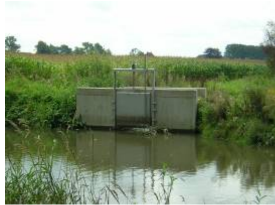
Figuur 2.7: Afsluitconstructie aan de instroomopening van de nevengeul.
