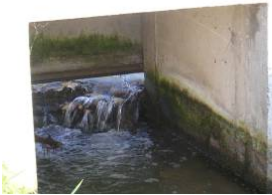
Figuur 4.4: Verstopping van de inlaatconstructie van de visnevengeul met boomstammen, takken en bladeren (oktober 2007 – stroomafwaarts aanzicht).
