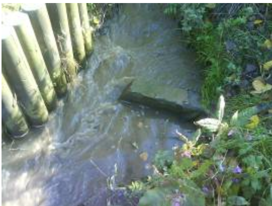
Figuur 4.17: Streckdam aan de uitstroomopening van de visnevengeul Ijzerkotmolen.
