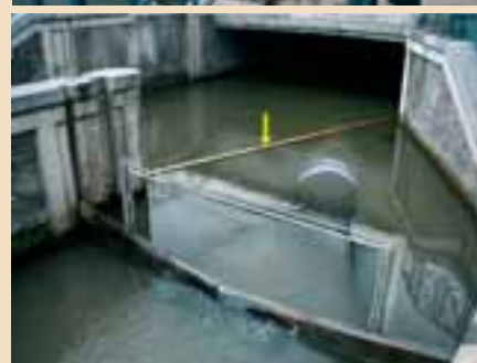
Foto 8: Goed geplaatste vistrapfuij en drijfbalk
