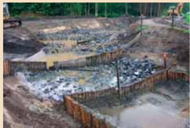
Foto 2.1: Bouw van de bekkenpassage met vertical slots met behulp van houten paaltjes, beton en stortstenen.
